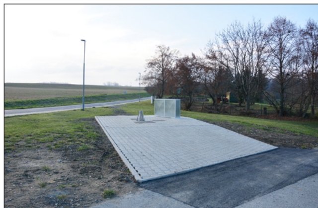
❑ Na obou stranách řeky vyrostly přečerpávací stanice
